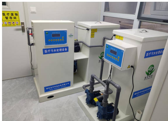
污水处理设施
