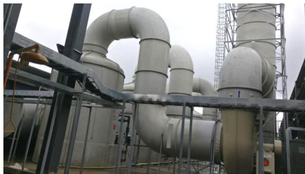
西侧并联碱液喷淋塔（3 用 1 备）
