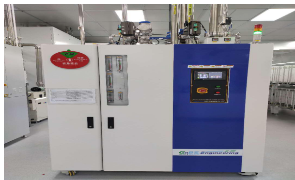
西侧设备(自带燃烧装置)
