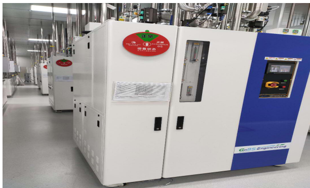
东侧设备(自带燃烧装置)
