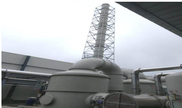
厂区东侧镀膜废气排气筒
