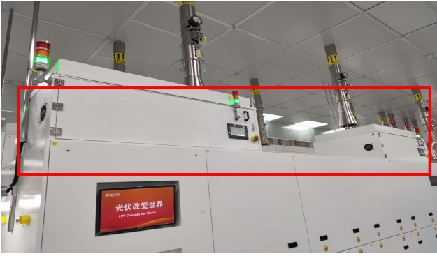
东侧烧结炉自带燃烧器
