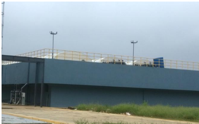
收集池、调节池废气收集罩
