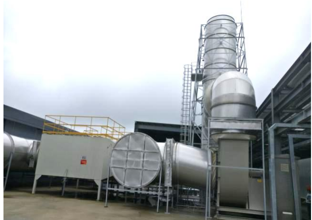
西侧有机废气排气筒
