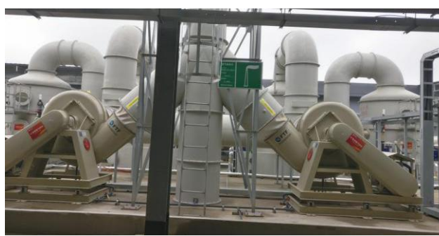
西侧风机（一用一备）及排放标牌
