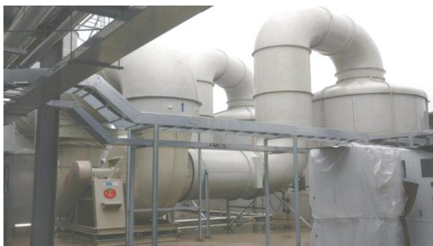
东侧并联碱液喷淋塔（3 用 1 备）
