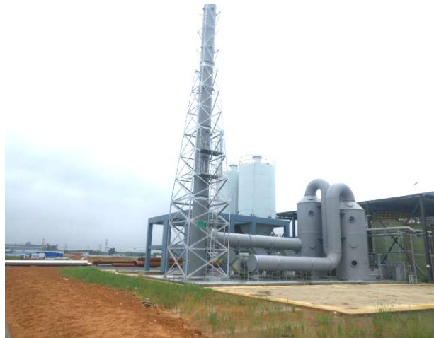
废水处理站排气筒
