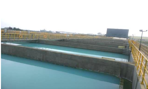
项目污水处理站
