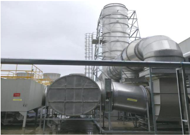
东侧有机废气排气筒
