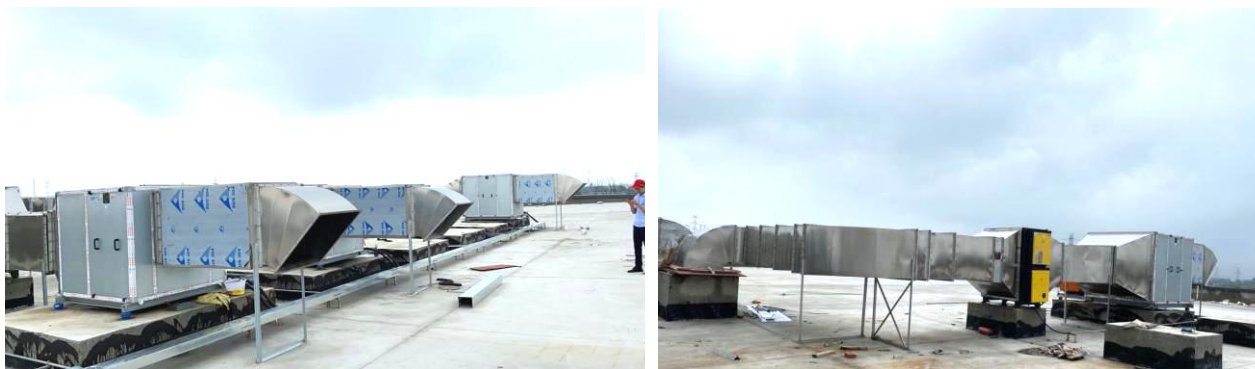
食堂油烟排口
