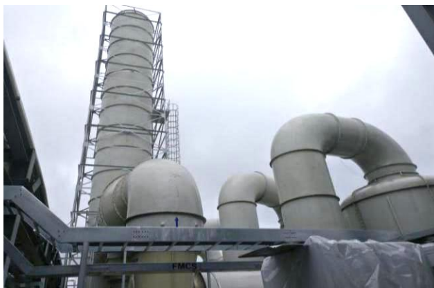
厂区东侧酸碱废气排气筒
