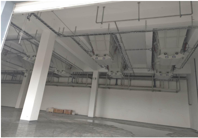
氟化钙污泥转运间
