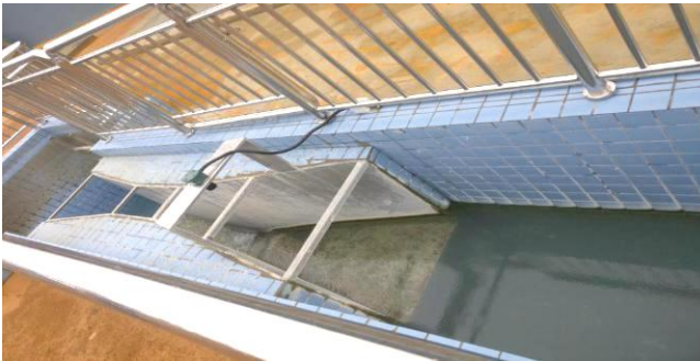
生产污水排口马歇尔槽
