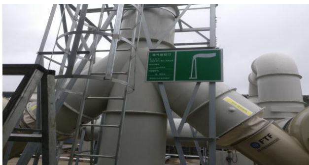
东侧风机（一用一备）及排放标牌
