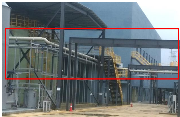
废气收集管道
