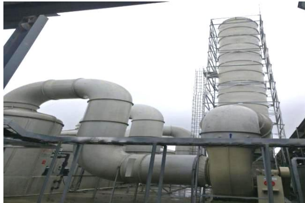
厂区东侧酸碱废气排气筒
